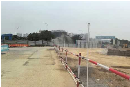
场内主干道喷淋系统
