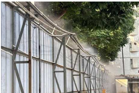
围挡喷淋系统
